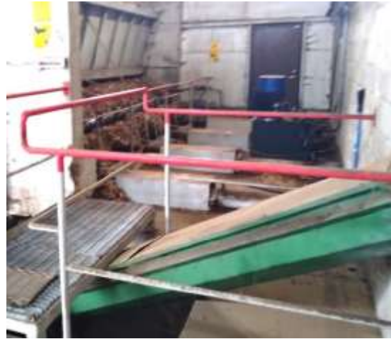
Foto 3.8 Hakke transportöörid katlaruumi
