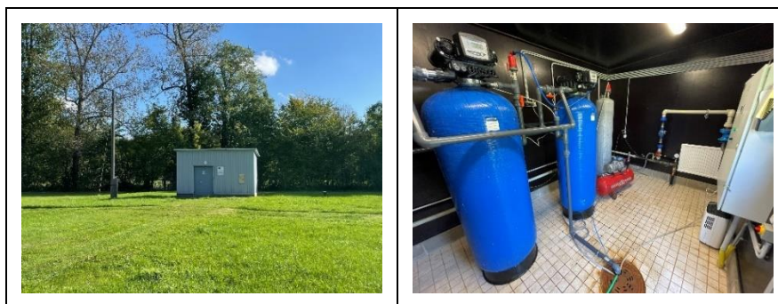
Fotod 4.14 Puurmani Lasteaia veetötlusjaam (2023).
