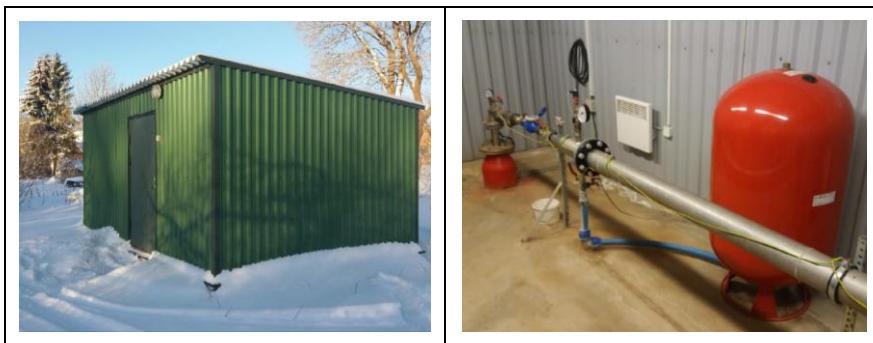
Fotod 4.6 Lossi tn puurkaev-pumpla (2023).
