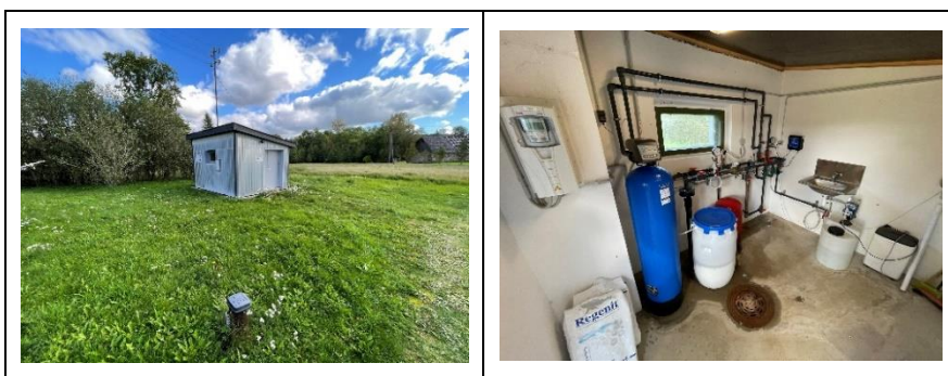
Fotod 4.23 Neanurme veetöötlusjaam (2023).
