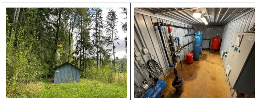
Fotod 4.18 Pisisaare veetötlusjaam ja Kasevõsa PRK (2023).
