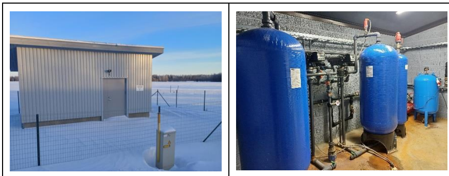
Fotod 4.13 Võisiku veetöötlusjaam (2023).
