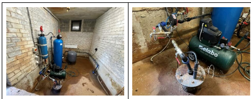
Fotod 4.21 Kalana veetöötlusjaam (2023).
