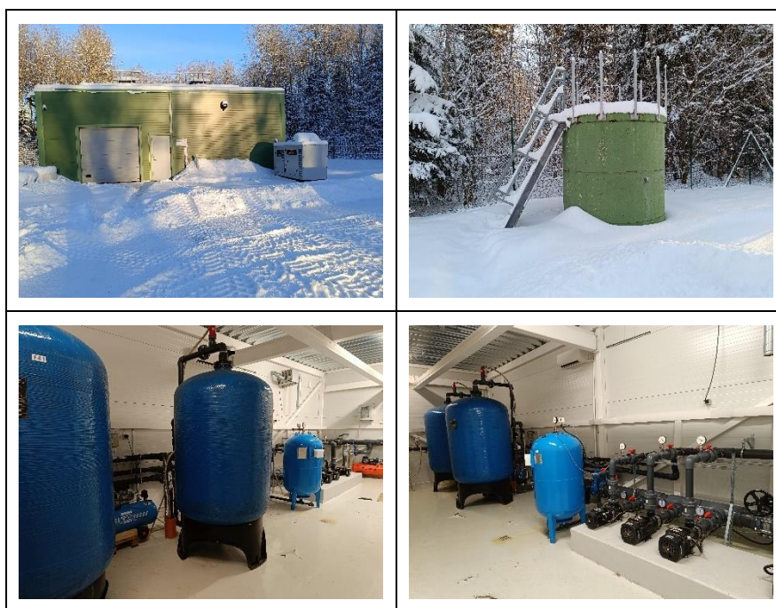
Fotod 4.1 Lembitu tn veetöötlusjaam ja II-astme pumpla (2023).
