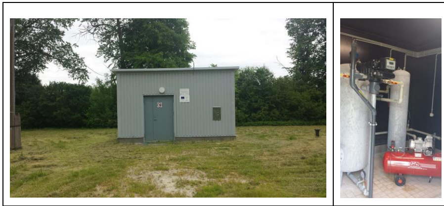
Joonis 3. Puurmani aleviku Lasteaia puurkaev-pumpla välis- ja sisevaade.
