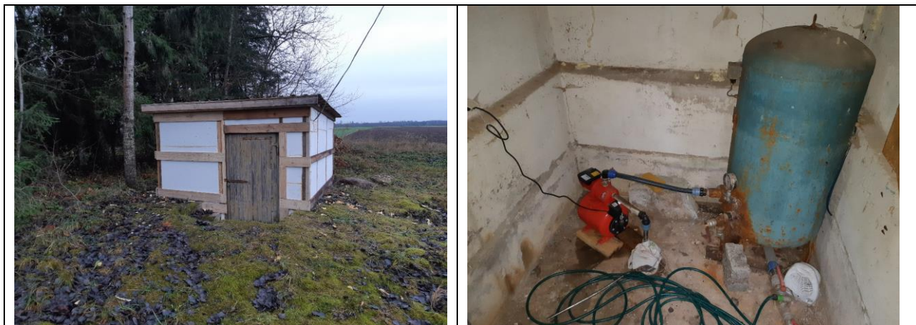
Joonis 4. Pikknurme küla Volli tee puurkaev-pumpla välis- ja sisevaade.
