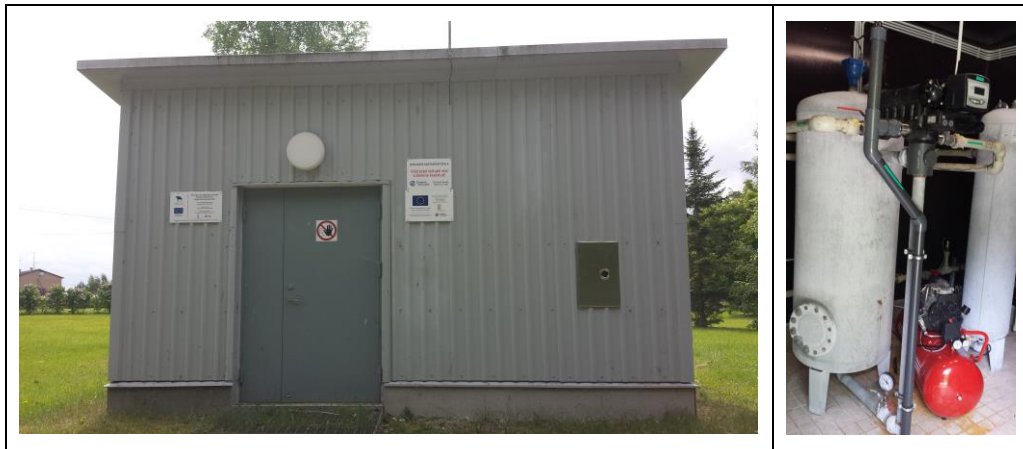
Joonis 2. Puurmani aleviku Suurelamute puurkaev-pumpla välis- ja sisevaade.
