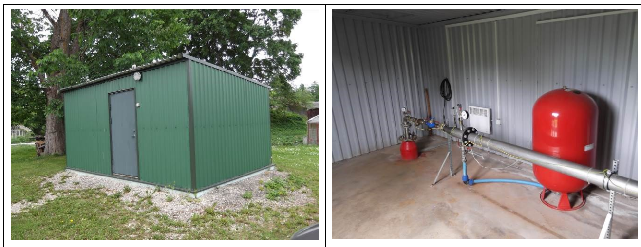
Joonis 9. Põltsamaa linna Lossi tn puurkaev-pumpla (katastri nr 8592). Fotod: OÜ Alkranel 29.05.2013.
