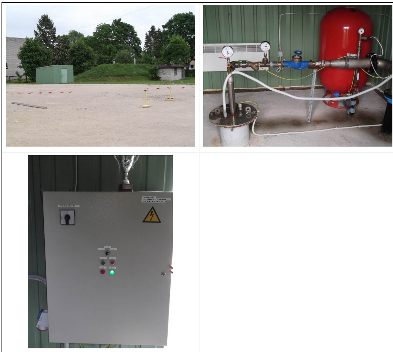
Joonis 7. Põltsamaa linna Kuuse tn puurkaev-pumpla (katastri nr 8587). Fotod: OÜ Alkranel 29.05.2013.
