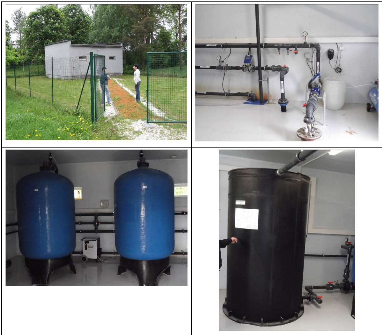
Joonis 5. Põltsamaa linna Lühikese tn puurkaev-pumpla (katastri nr 8600) ja veetöötlusjaam. Fotod: OÜ Alkranel 29.05.2013.
