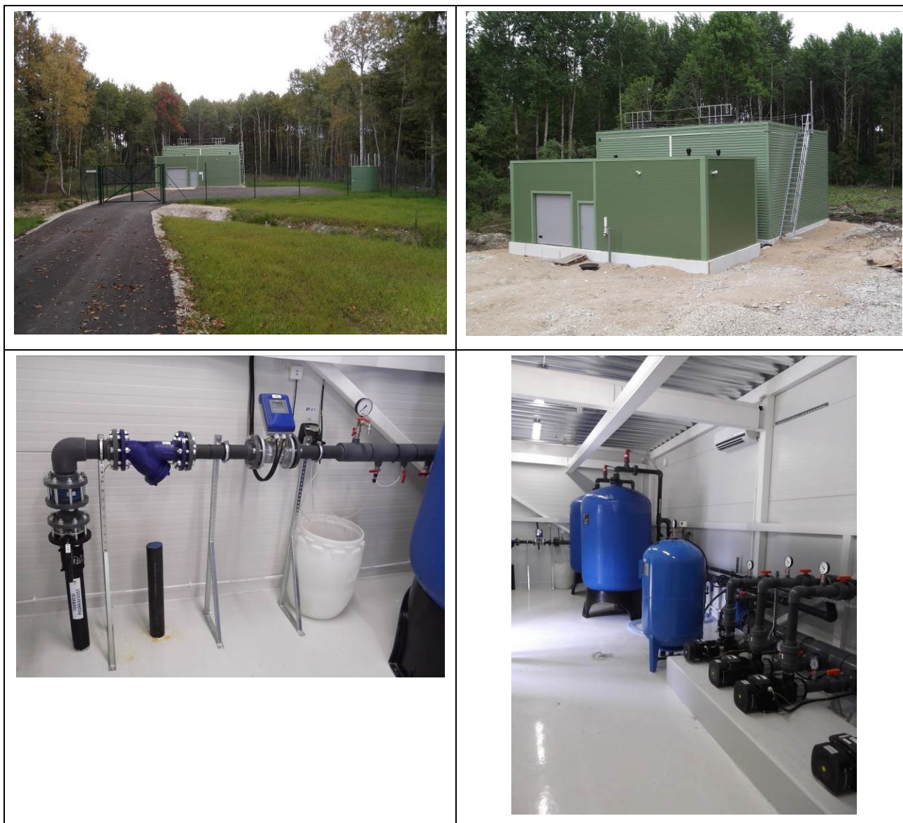
Joonis 4. Põltsamaa linna Lembitu tn puurkaev-pumpla (katastri nr 51547) ja veetöötlusjaam. Fotod: OÜ Alkranel 29.05.2013 ja 30.09.
