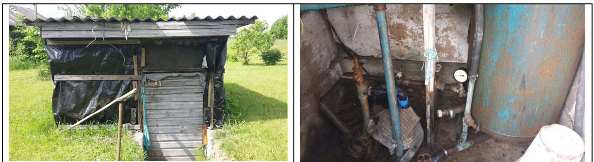
Joonis 6. Pikknurme küla nr 1 puurkaev-pumpla välis- ja sisevaade.
