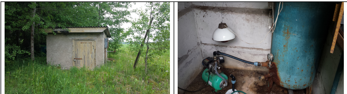
Joonis 5. Pikknurme küla nr 1 puurkaev-pumpla välis- ja sisevaade.
